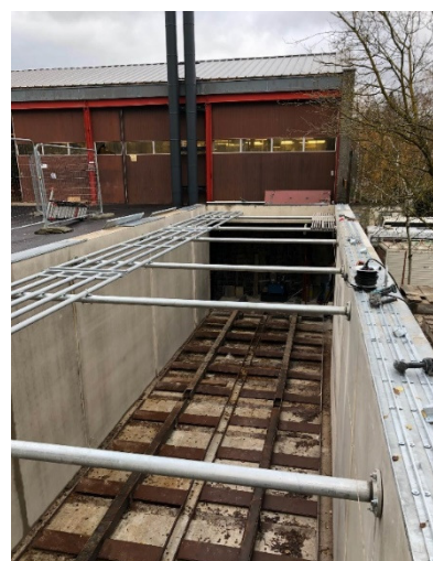
La Reid – silo à biomasse
