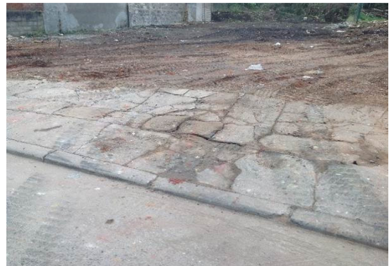
Dégradations de la voirie
