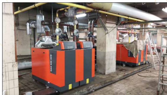
Un exemple de chaudières remplacées
